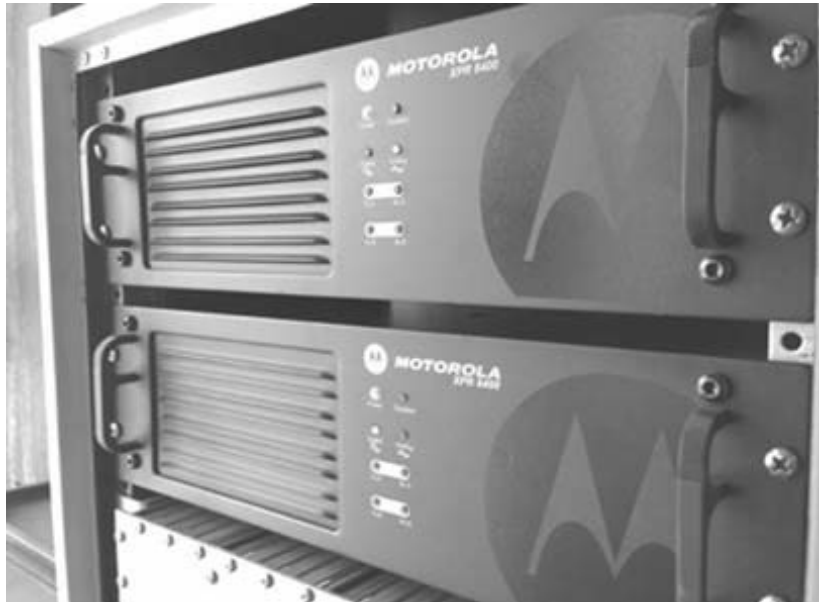
Figura 3: Dos repetidoras DMR Motorola.
