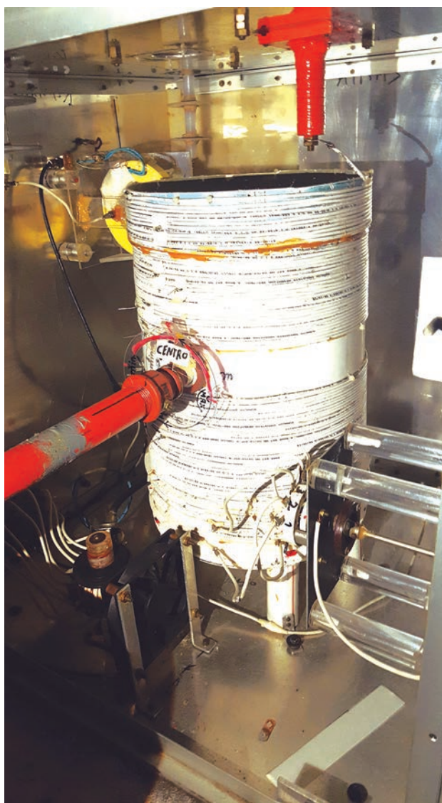
Variómetro de LF con toma de derivaciones a la derecha, sintonía remota al centro, balun adaptador con ventilador abajo y medidor de corriente de RF en amarillo.
